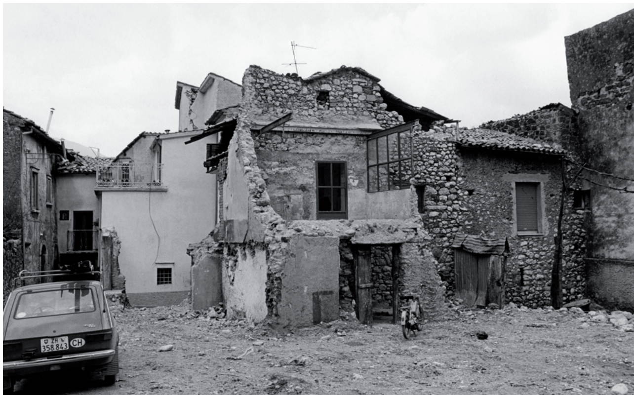
Un fabbricato nel centro storico di Montella sbriciolato dal sisma.
